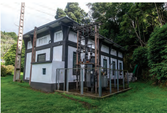
Figura 8 – Central Hídrica de Nasce Água
